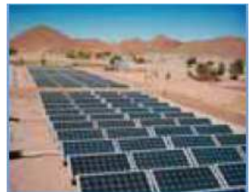
Champ photovoltaïque Source : Tenesol
