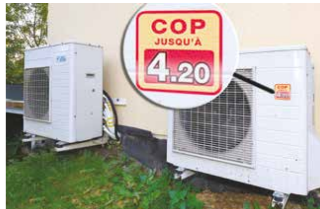
Les variations entre le COP annoncé et la performance réelle sont très nettes pour les PAC aérothermiques, surtout celles sur air extérieur.
