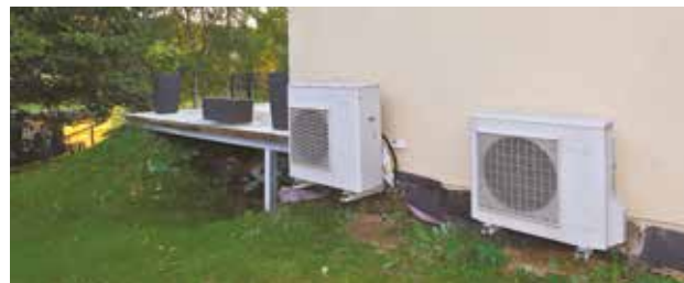
Attention au voisinage, certaines unités extérieures de pompes à chaleur aérothermiques sont plus bruyantes que d'autres.
