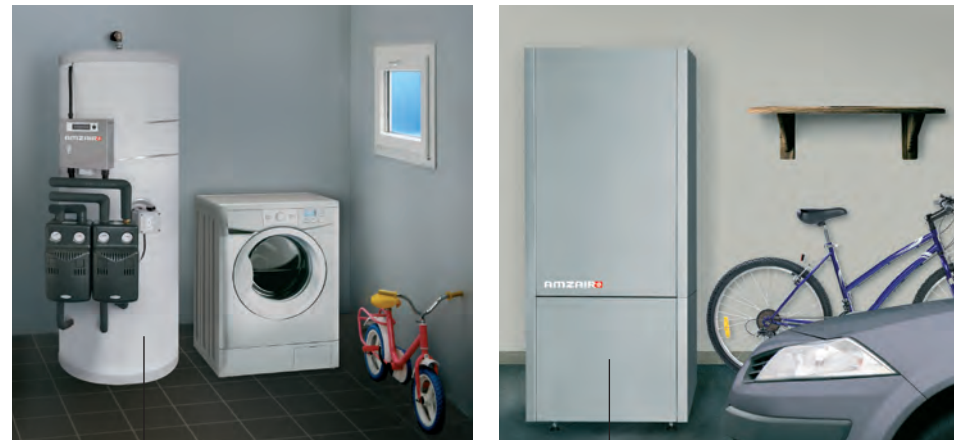
ECS (eau chaude sanitaire)
