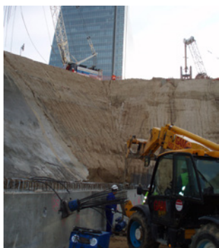
Mise en tension de tirants câble - Centre de Convention International à Madrid - Espagne
