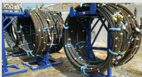
Portiques pour stockage et transport
